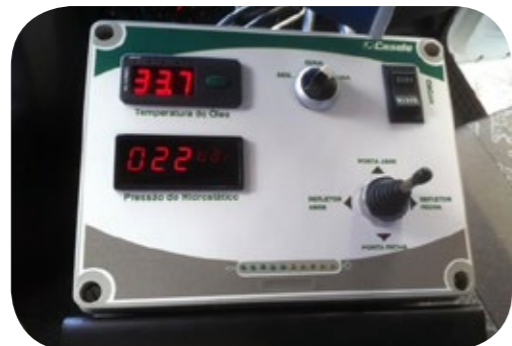
Sistema de control con palanca de mando instalada en la cabina del camión y también con una pantalla que muestra la temperatura del aceite y la presión del sistema hidrostático.
